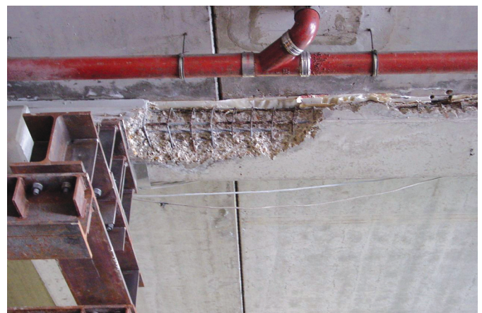
Bild 7. Schwere Betonschäden an tragender Stütze
