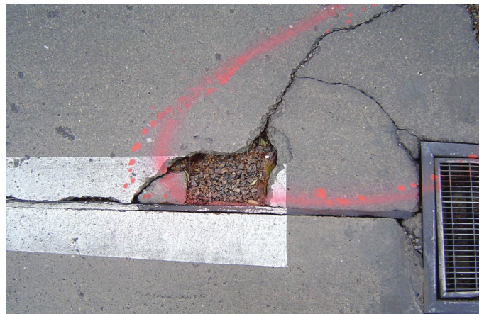
Bild 3. Kantenabplatzungen und Ausbrüche
